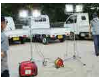
整備された発電機と投光器
